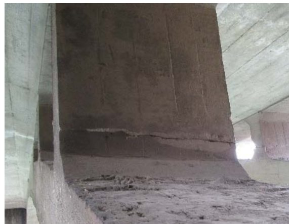
Figura 9. Fisura en arranque de montante.
