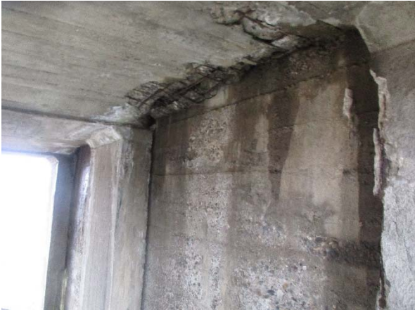
Figura 10. Desconchones en losa en zona de junta.
