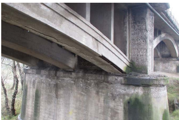
Figura 7. Lajaciones en arco y perfiles metálicos vistos y oxidados.
