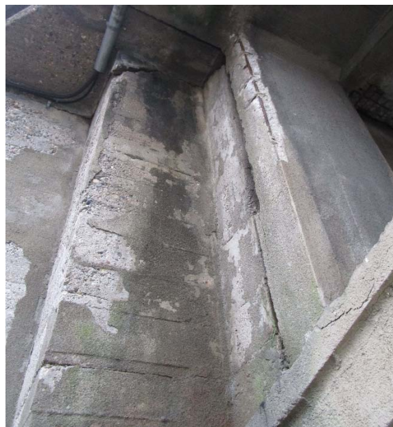
Figura 8. Desconchones con armadura vista corroída en montantes situados en el arranque del arco.
