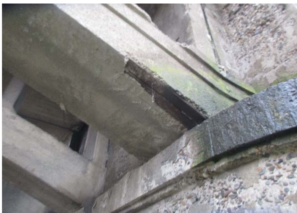
Figura 6. Perfiles metálicos vistos y con avanzado estado de oxidación por estallido del hormigón de recubrimiento.
