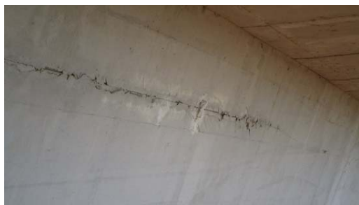
Figura 3. Vista general de fisura longitudinal tipo de viga.
