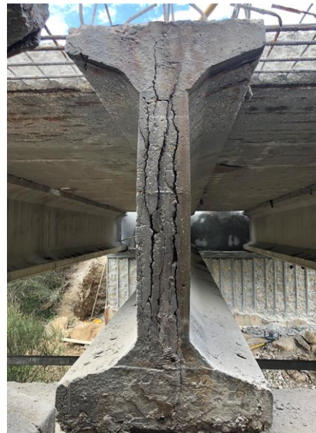
Figura 12. Detalle de degradación de hormigón de alma
