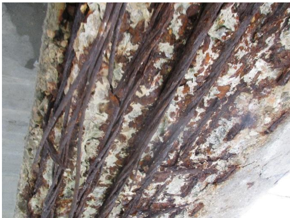
Figura 7. Detalle del estado del pretensado en cara inferior de viga doble “T”
