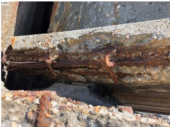
Figura 10. Detalle cables de pretensados afectados por corrosión
