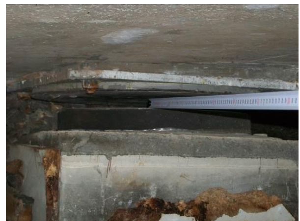
Figura 5. Falta de contacto en los aparatos de apoyo.
