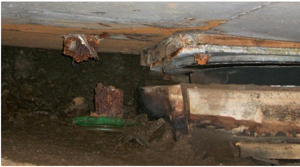
Figura 6. Rotura de los cables de retenida.
