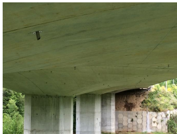
Figura 15. Desagües en cara inferior del tablero
