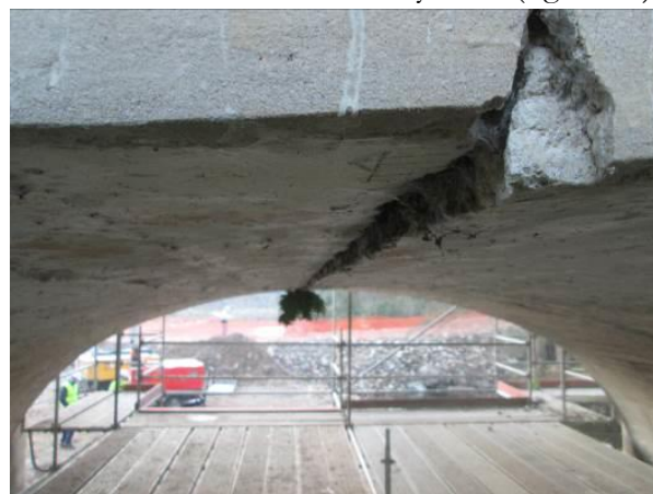
Figura 13. Detalle de “ceja” en bóveda por giro de cimentación.
