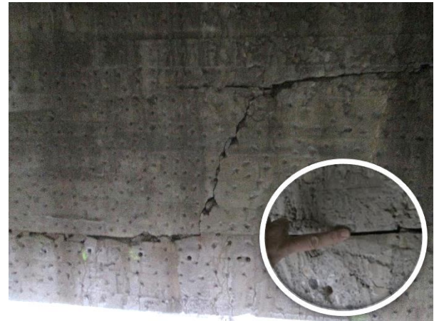
Figura 15. Detalle de grieta de rasante en tablero en origen en las juntas frías no tratadas de hormigonado. Detalle de junta
