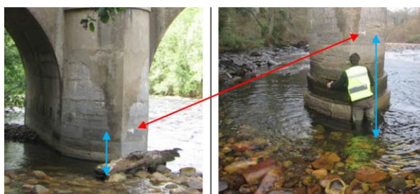
Figura 8. Detalle de evolución de la erosión local en 4 años, pudiendo estimar el lavado de material en el entorno de los 1,50 m
