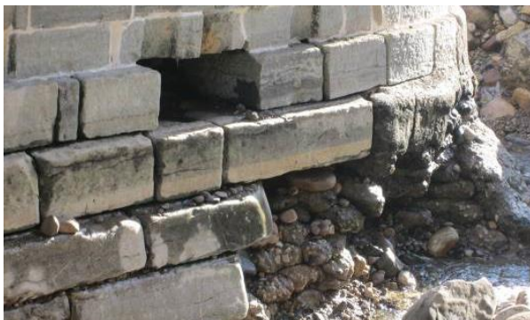
Figura 18. Pérdida de sillares y lavado interior de cimentación.
