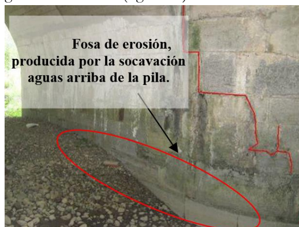
Figura 10. Aparición de grietas en pilas por asientos diferenciales de cimentación.
