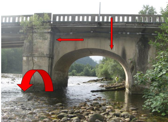
Figura 11. Giro en cimentación por socavación, acentuado por el desequilibrio de empujes horizontales, con el consiguiente movimiento de sólido-rígido y agrietamiento de la bóveda.
