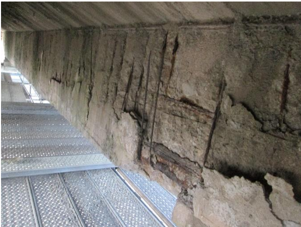
Figura 14. Degradación superficial generalizada del hormigón con armaduras vistas corroídas.
