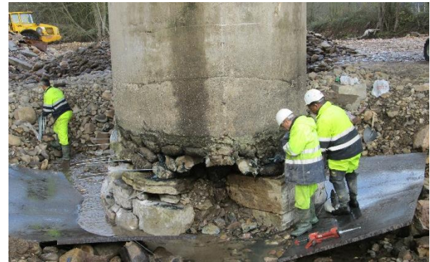
Figura 19. Pérdida de sillares y lavado interior de cimentación.
