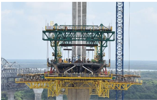
Figura 19. Vista frontal de los carros de avance (superior) y de alas (inferior)
