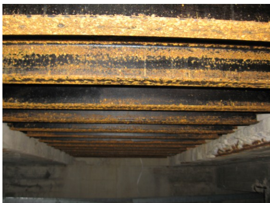
Figura 5. Palastros metálicos para el cierre de huecos transversales.
