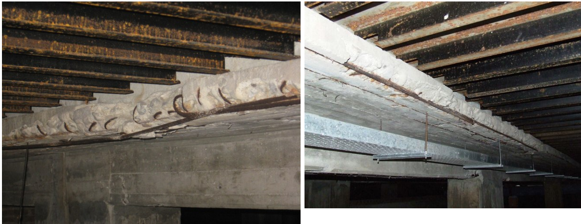
Figuras 11 y 12. Rotura de ménsulas cortas de losa, con numerosas zonas en las que armaduras están oxidadas. También se observa la degradación del hormigón con la consiguiente pérdida de la geometría original de las ménsulas.
