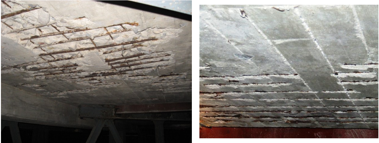
Figuras 9 y 10. Numerosas zonas de losa con pérdida de recubrimiento y armaduras transversales oxidadas.
