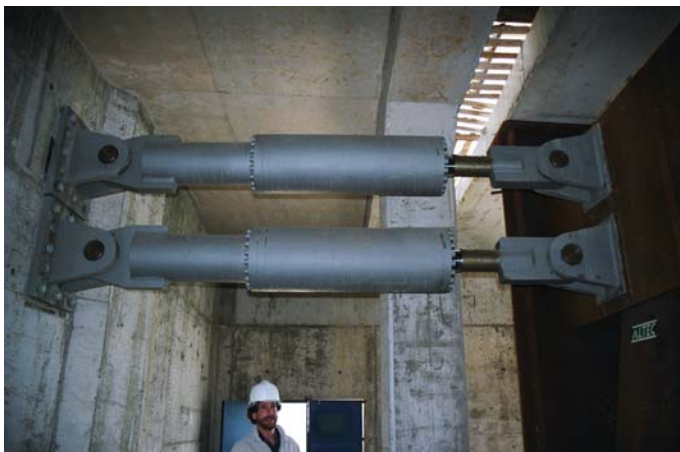
Figura 3. Transmisores de impacto en el Viaducto Arroyo de Las Piedras (L.A.V. Córdoba-Málaga).
