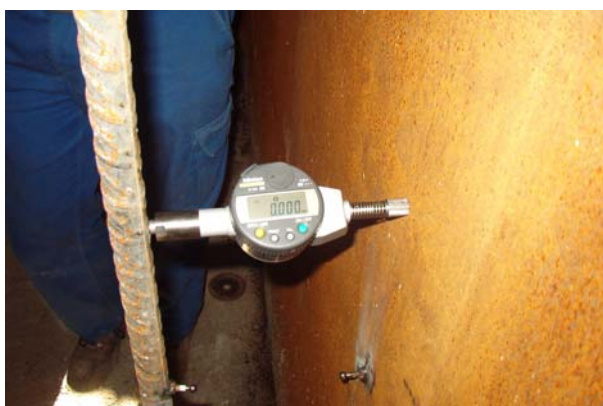
Fig. 22 Control deformaciones transversales en el alma
