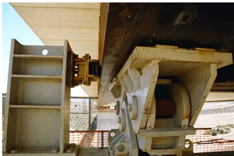
Fig. 13 Detalle de apoyos deslizantes con topes laterales durante el empuje
