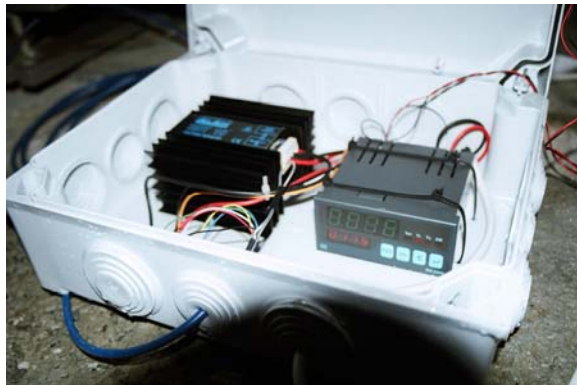
Fig. 27 Caja con convertor de señal del clinómetro y con el limitador de giro máximo admisible
