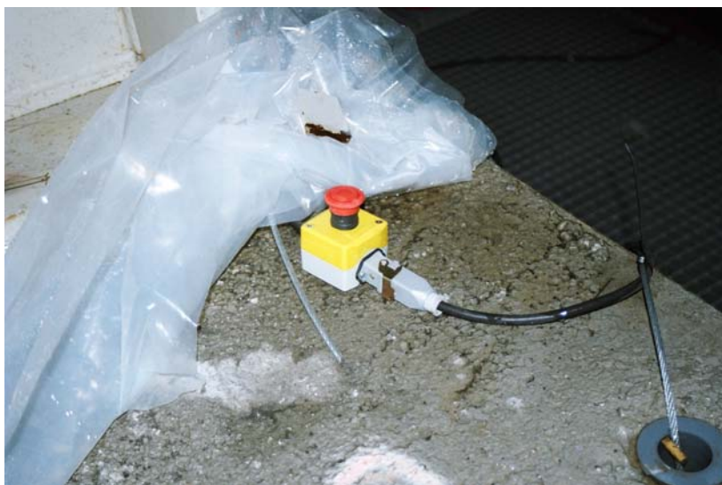
Fig. 28 Vista del sistema de parada en cada pila (Seta)
