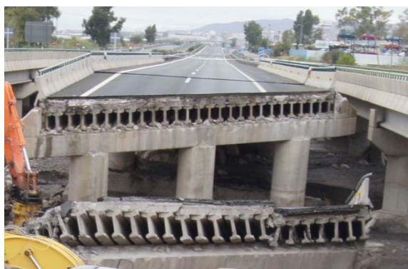
Figura 6. Vistas generales de la estructura colapsada
