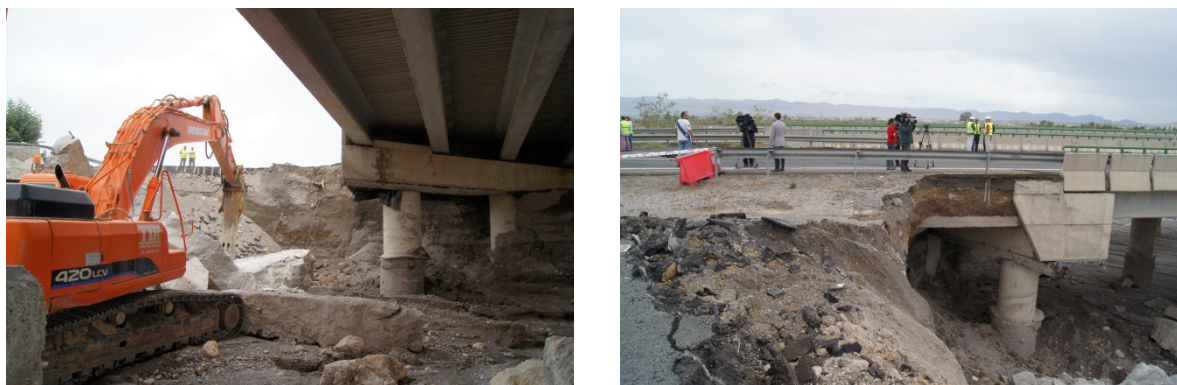
Figura 8. Vista general y detalle de estribo 2 de la calzada sentido Murcia y descalce de losa de transición
