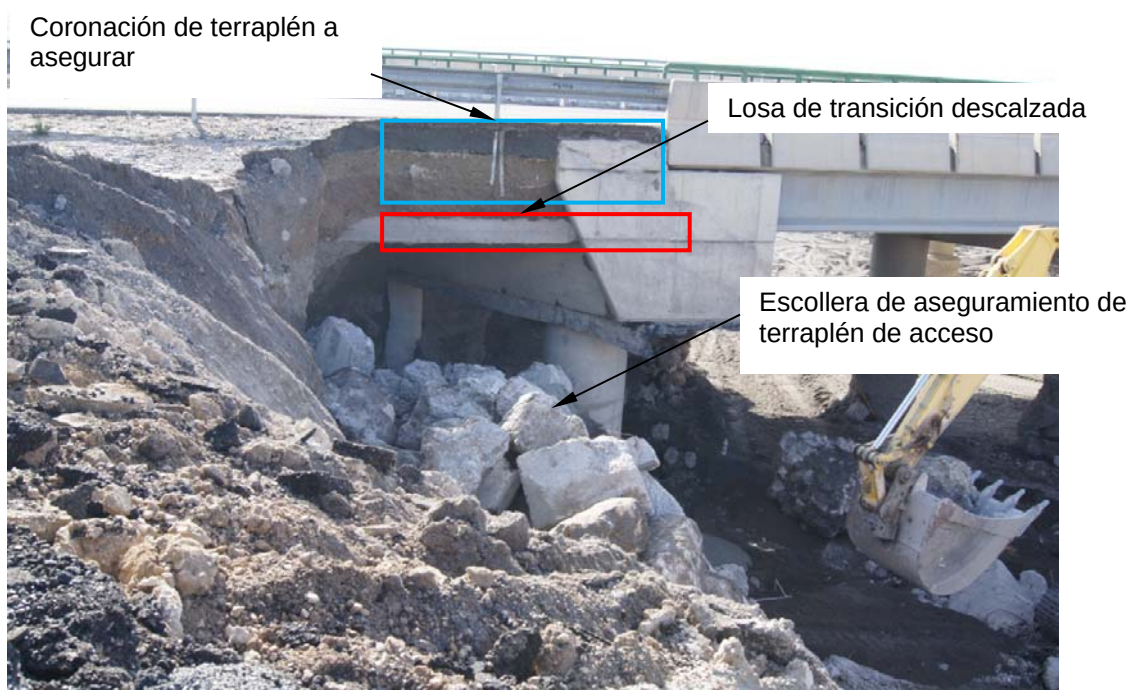
Figura 9. Descalce en calzada sentido Murcia. Trabajos de reconstrucción provisionales de emergencia
