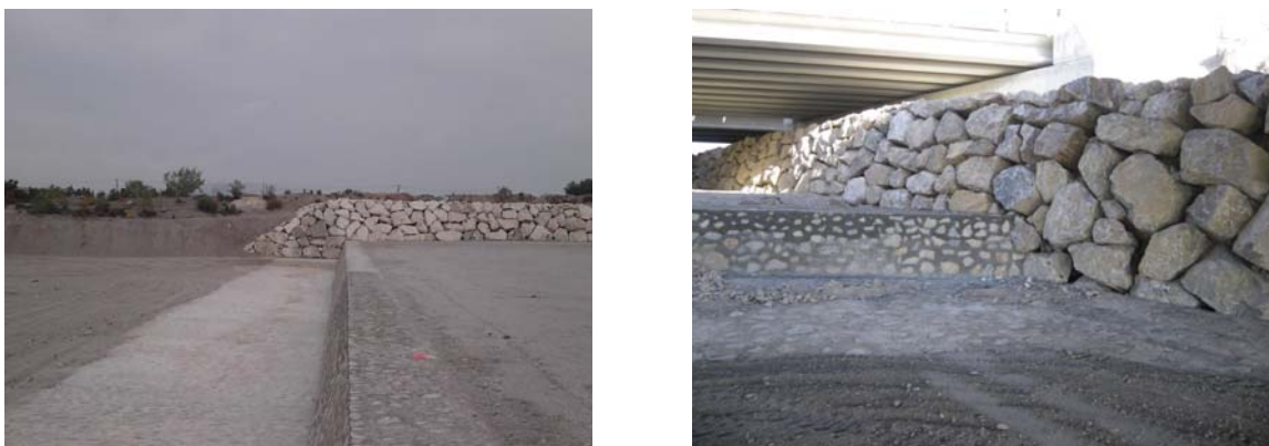
Figura 22. A la izquierda, vista del perfil de estabilización del cauce junto con su cuenco amortiguador. A la derecha, detalle de intersección entre muro transversal y muro lateral de encauzamiento
