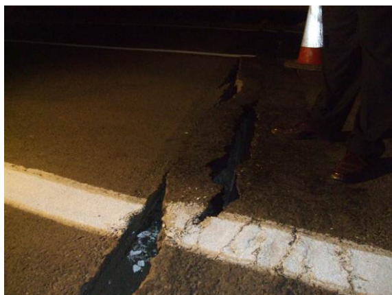
Figura nº 8. Abertura de unos 8-10 cm de la junta
