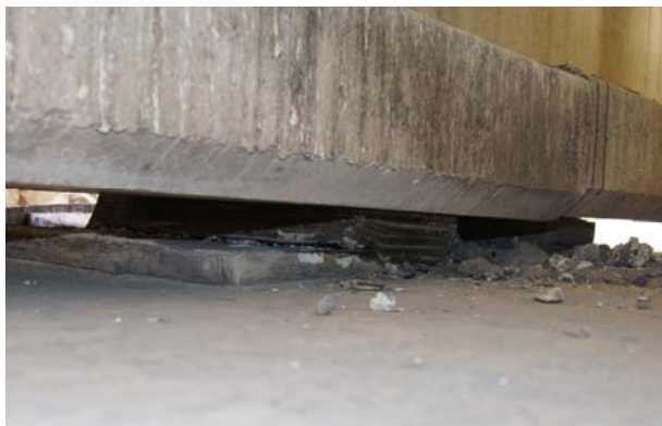
Figura nº 10. Descalce de apoyos por la acción del sismo.
