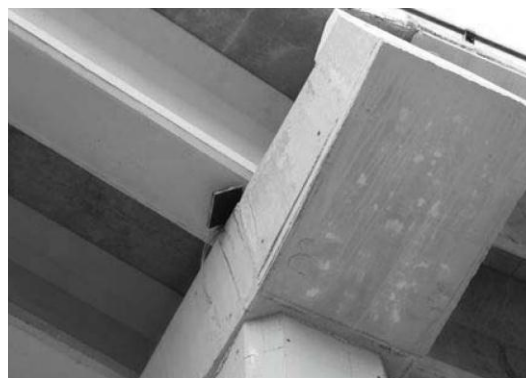
Figura 16. Aparato de apoyo de neopreno zunchado a punto de caerse del dintel de pila, expulsado por la ausencia de cuña de nivelación.
