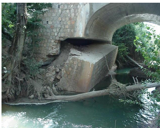
Figura 3: Colapso de estructura por socavación del estribo.
