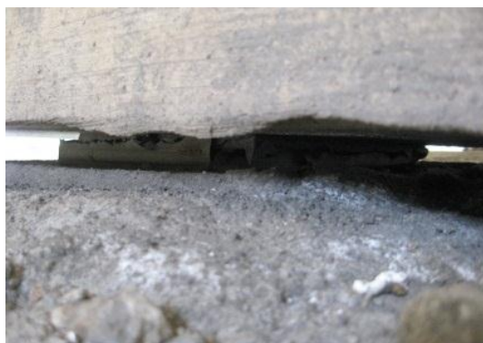
Figura 15. Rotura de aparato de apoyo de neopreno zunchado por deficiente dimensionamiento para los movimientos impuestos.
