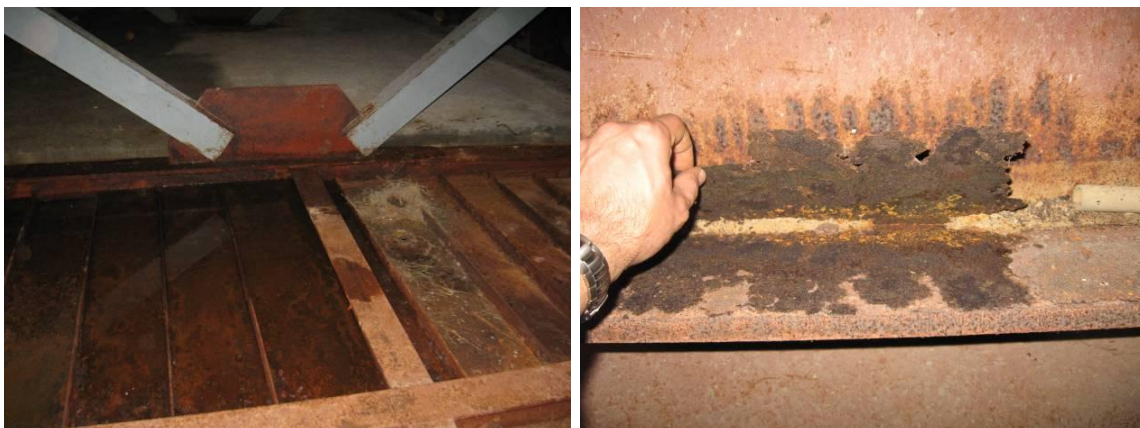
Figuras 13 y 14. Interior de un cajón mixto de acero corten con importantes filtraciones de agua, habiendo degenerado en el deterioro del sistema de pintura y la oxidación del acero autopatinable, al no ser capaz éste de generar la capa de pátina debido a la falta de ventilación, la alta humedad y condensación interior del cajón.
