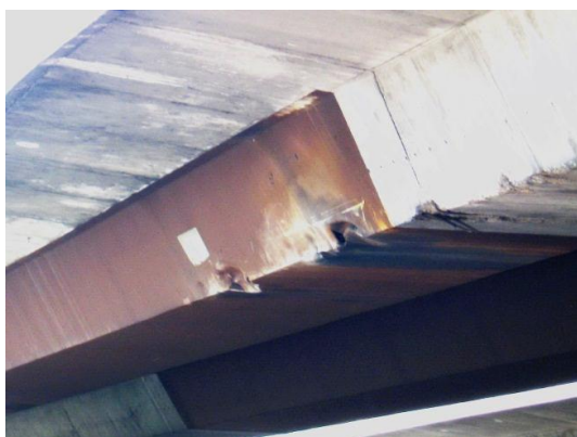
Figura 27. Daños en cajón metálico por impacto de vehículos con exceso de gálibo. Se puede observar en la zona de losa, diferentes golpes sin apenas repercusión estructural.
