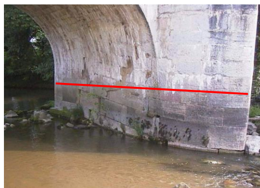
Figura 6: Asientos diferenciales en pila de obra de fábrica por socavación. Ver línea de sillares.
