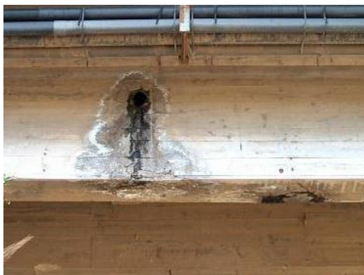
Figura 23. Degradación del hormigón por la presencia de un imbornal carente de bajante y/o elementos de desagüe adecuados.
