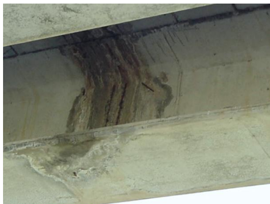
Figura 24. Daños en viga de borde por falta de bajante en sumidero, escurriendo el agua por el alma de la viga, produciendo la degradación y del hormigón y la corrosión de las armaduras.
