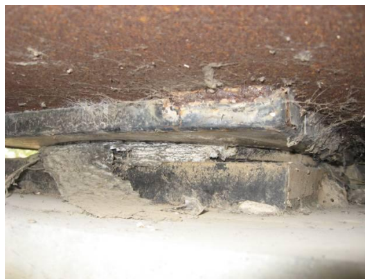
Figura 18. Rasgado y expulsión de la lámina de teflón por la falta de paralelismo entre la cara superior e inferior del tablero.
