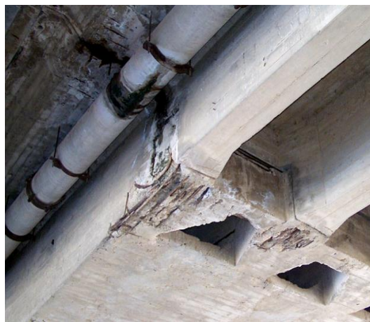
Figura 20. Degradación del hormigón y con armaduras vistas en detalle de apoyo a media madera por circulación de agua.
