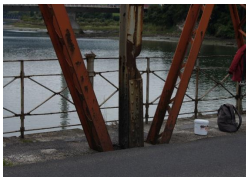
Figura 9. Comienzo de degradación de pintura de protección en elemento metálico. Golpes por impacto en estructura metálica.
