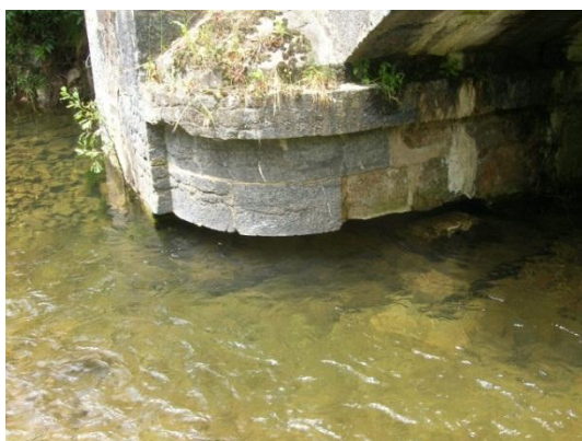
Figura 5: Muro de frente de obra de fábrica totalmente descalzado debido a la erosión del cauce.
