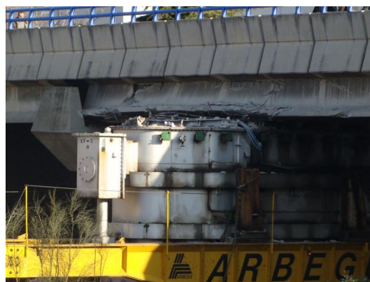
Figura 28. Rotura completa de viga por vehículo circulando con exceso de gálibo.
