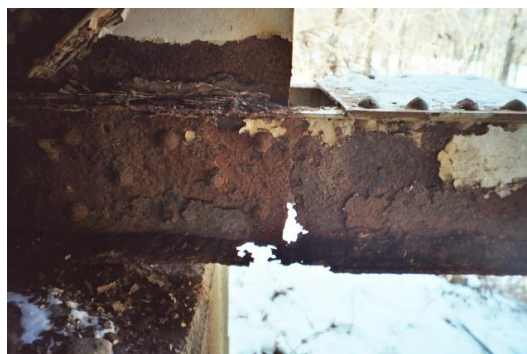
Figura 10. Oxidación de platabanda metálica por circulación de agua y acumulación de suciedad.
