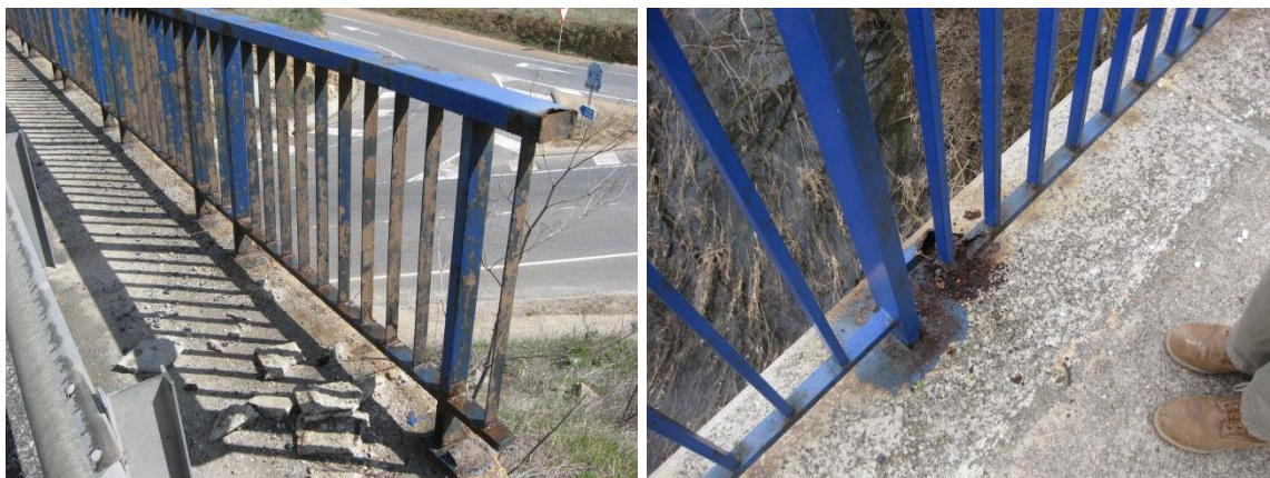
Figuras 35 y 36. Deterioro de sistemas de contención metálicos.
