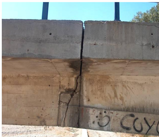
Figura 19. Rotura de ménsulas cortas en detalle de apoyo a media madera, debido a la geometría estricta del detalle de apoyo.
