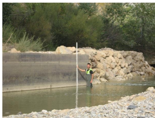
Figura 4: Inspección de cimentación. Cimentación en avanzado estado de socavación, llegando a un estado crítico.
