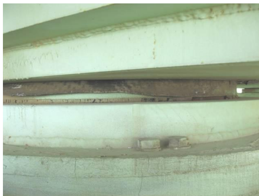
Figura 17. Rebosamiento de la lámina de teflón (PTFE) del apoyo tipo POT, por deficiente calidad del aparato de apoyo.
