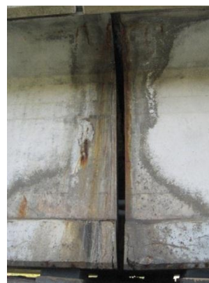
Figura 22. Degradación del hormigón con armaduras vistas en culatas de vigas por circulación de agua a través de junta de dilatación.
