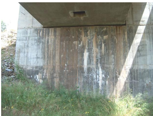
Figura 21. En la derecha desarrollo de ataque por sulfatos en el hormigón, acentuado por el agua que circula por el estribo a través de la junta de dilatación.
